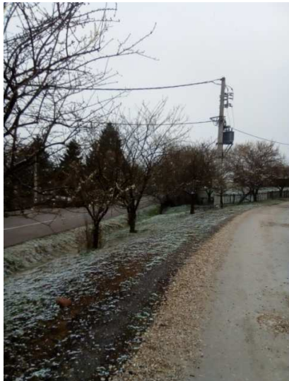
Слика 3 – Стубна трафо-станица на углу
